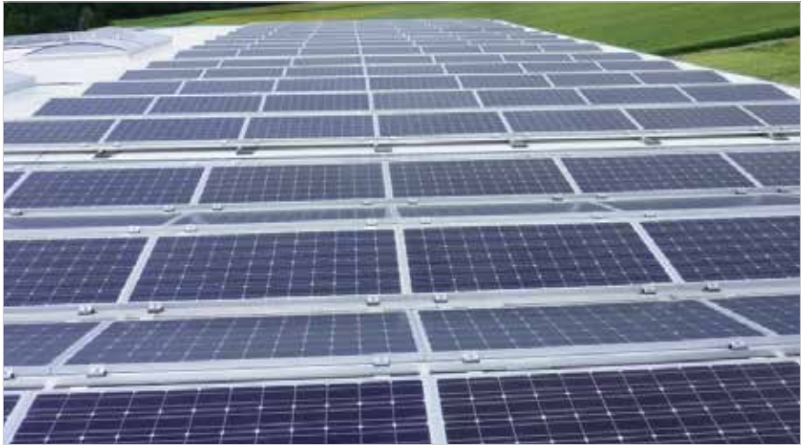
Hamburg | Deutschland Anlage: 70 kW | D-Level System
